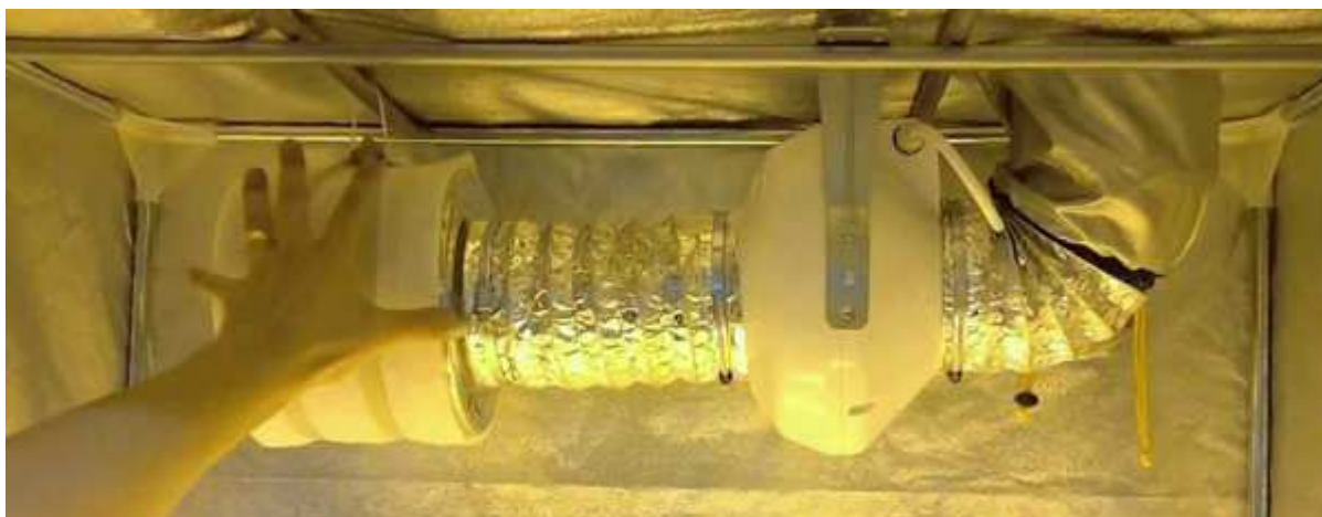
9. Ejemplo conexión extractor y filtro dentro del armario
